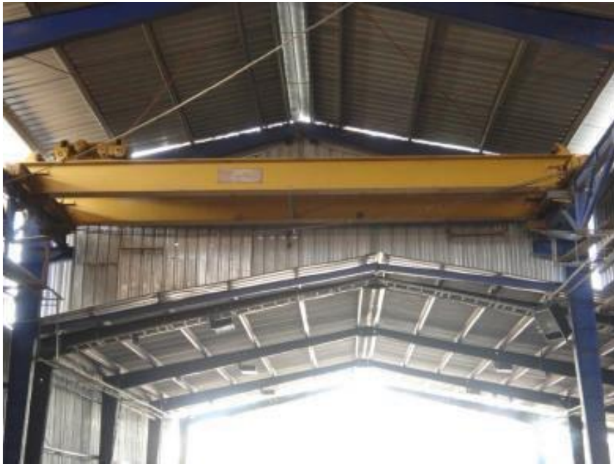
Puente grúa 20 ton
